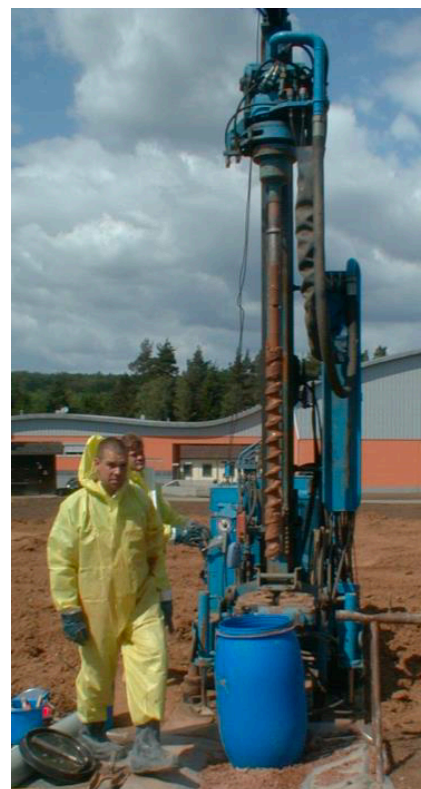
Forage profond pour cellules de prélèvement à des fins de surveillance des effets de dépollution sur site à risque
